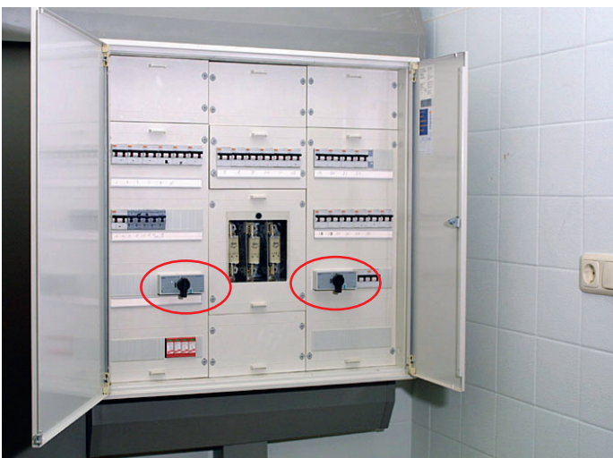
Schakel- en verdeelinrichting met twee lastscheiders die elk een gedeelte van de schakel- en verdeelinrichting scheiden.
