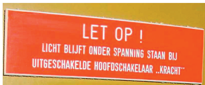
Indien noodzakelijk kan de schakel- en verdeelinrichting worden voorzien van een tekstplaat met een tekst waaruit blijkt dat niet de gehele schakel- en verdeelinrichting wordt gescheiden. Deze tekstplaat waarschuwt dat de installatie voor verlichtingsdoeleinden niet wordt gescheiden bij een uitgeschakelde hoofdschakelaar van de 'krachtinstallatie'.
