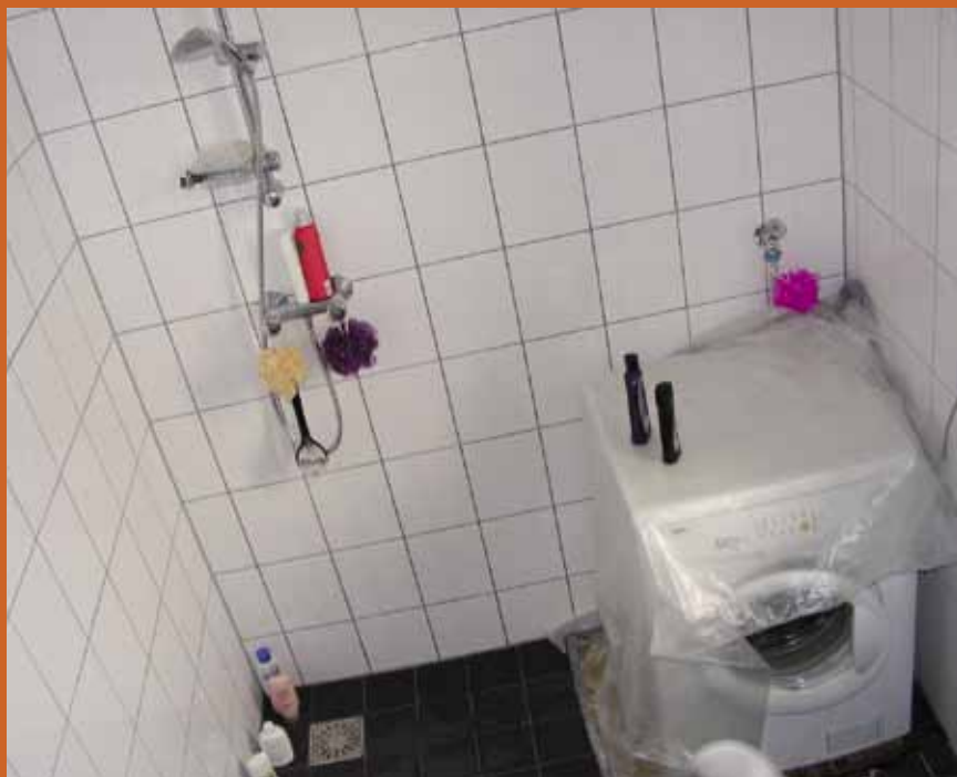
In een badkamer is een opstelplaats voor een wastoestel gerealiseerd. Alleen de wandcontactdoos is volgens de voorschriften geplaatst.
